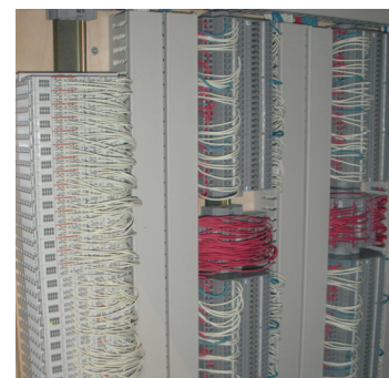
Bild 64 – Teilsicht der elektronischen Steuerung
