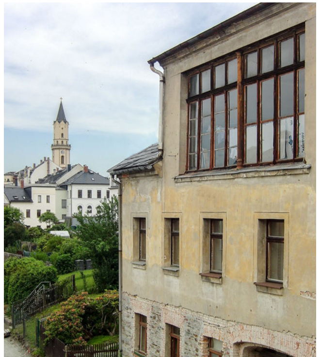
Markneukirchen, Krumme Str. 5, Wilhelm Paulus, Fensterereinbau 1870, ein gleich großes Ostfenster wurde zugemauert.
