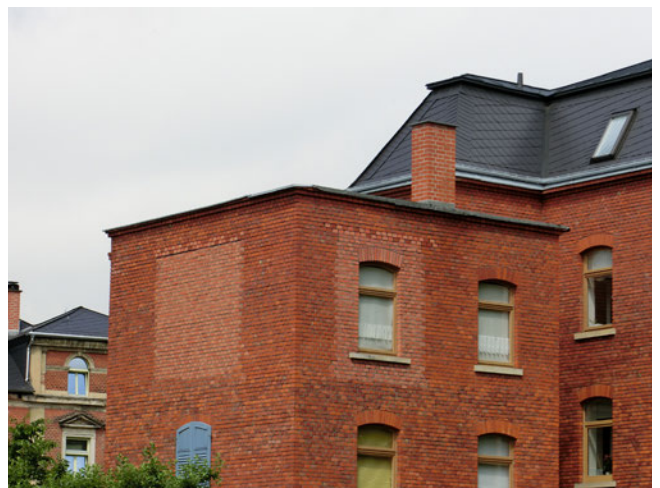
Markneukirchen, Erlbacher Str. 76, August Ernst Geipel, zugemauertes Süd-, verändertes Ostfenster
